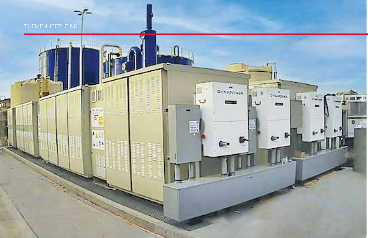
Zwei MWh Redflow-Zink-Brom-Flow-Batterie-Energiespeicher und Dynapower-Wechselrichter in der Anaergia-Biogasanlage, Kalifornien
